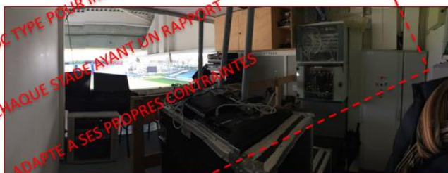
Espace Régie LED club très restreint
