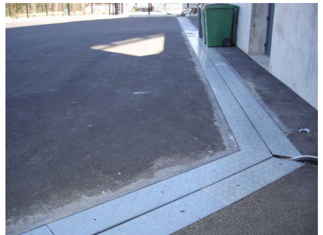
Passage de câbles sous terrain - Mise en sécurité des câbles
