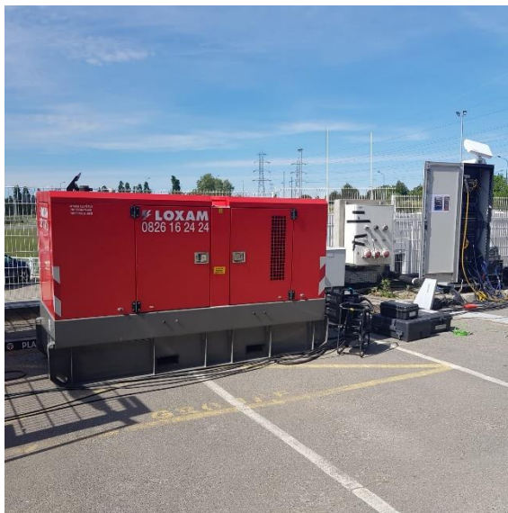
Exemple groupe électrogène sécurisé et isolé
