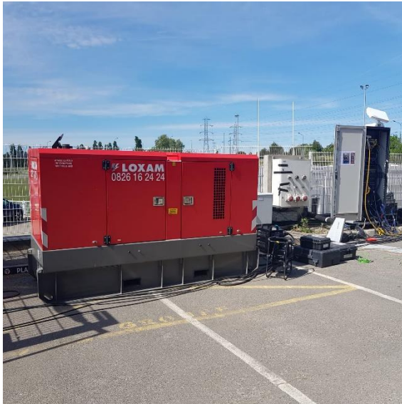
Exemple groupe électrogène sécurisé et isolé
